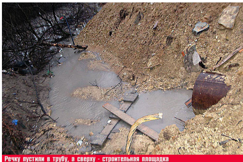
Речку пустили в трубу, а сверху - строительная площадка
