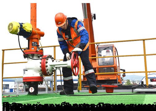
Т. Бондаренко, ДУМФУМН Электрооборудования
